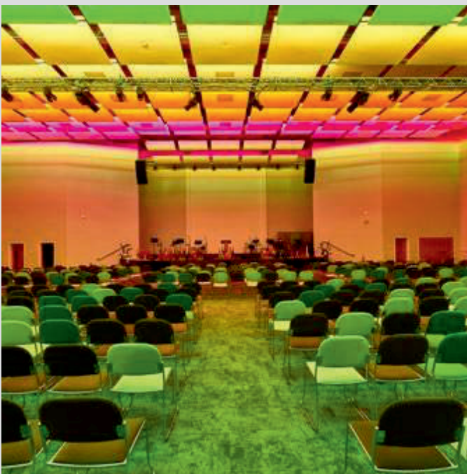
IGLESIA - REINO UNIDO CAJONES LUMINOSOS CON LUZ LED RGB - INSTALACIÓN : Acoustic GRG
